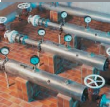
Горизонтальный монтаж бустерных насосов на станции водоснабжения в г. Ауз (Германия)
