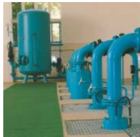
Система водоснабжения в Деммине (Германия)
