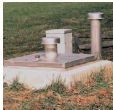
Вынесенный на поверхность оголовок скважины
