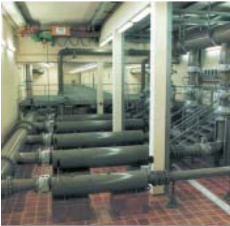
Горизонтальный монтаж бустерных насосов на станции водоснабжения в г. Штраубинге (Германия)
